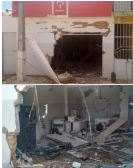
O Bradesco de Jussara ficou completamente destruído
